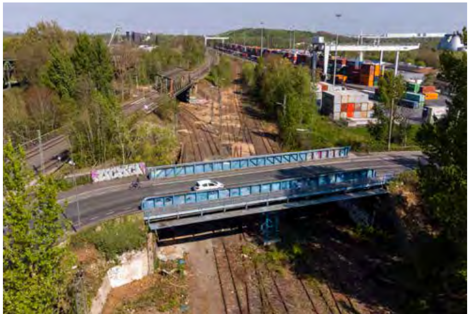
Bevor die Bahn die Zubringergleise zum ICE-Werk erneuert, muss die Brücke abgerissen sein - die Stütze (mittig) steht schlicht im Weg.
