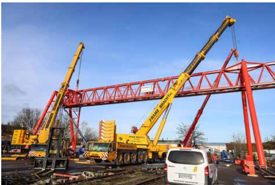
Der neue, auf 100 Tonnen ausgelegte Portalkran dient auch dem Umschlag von Komponenten für Windkraftanlagen.
